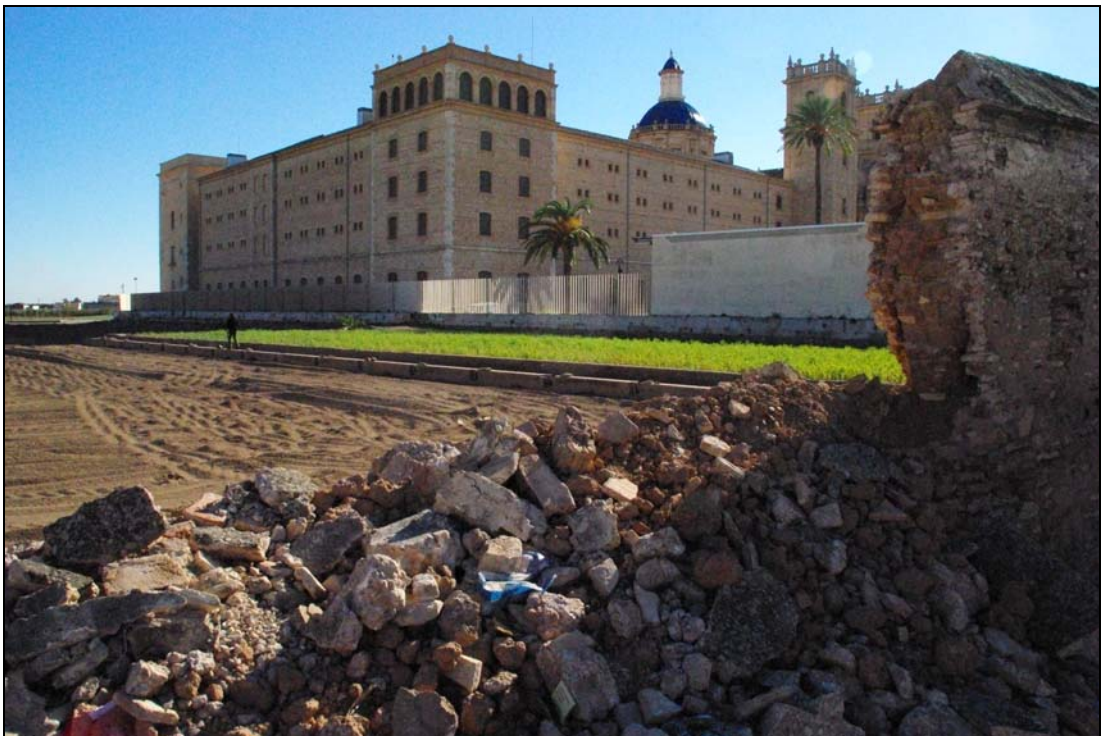
Muro derribado pendiente reconstruir
